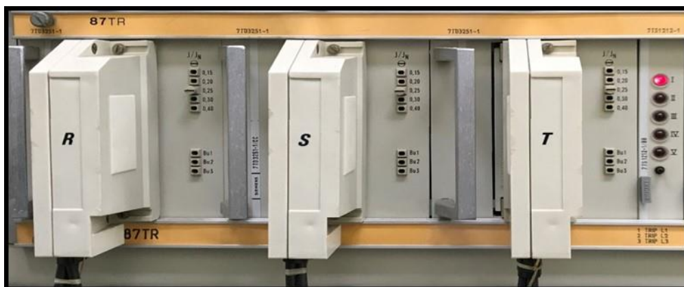
Figura 7.12: Módulos del relé 87TR.
