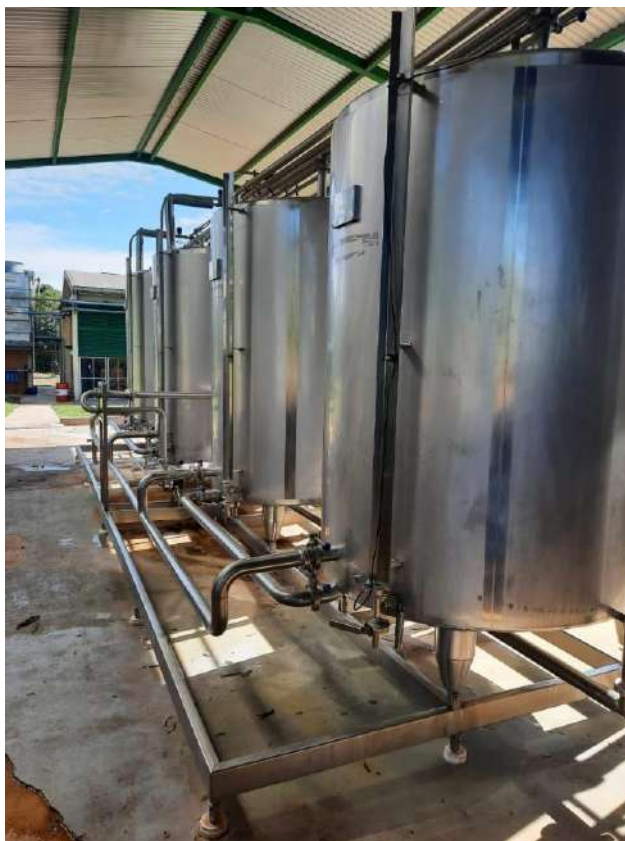
Figura B.3 Tanques del sistema CIP Lateral
