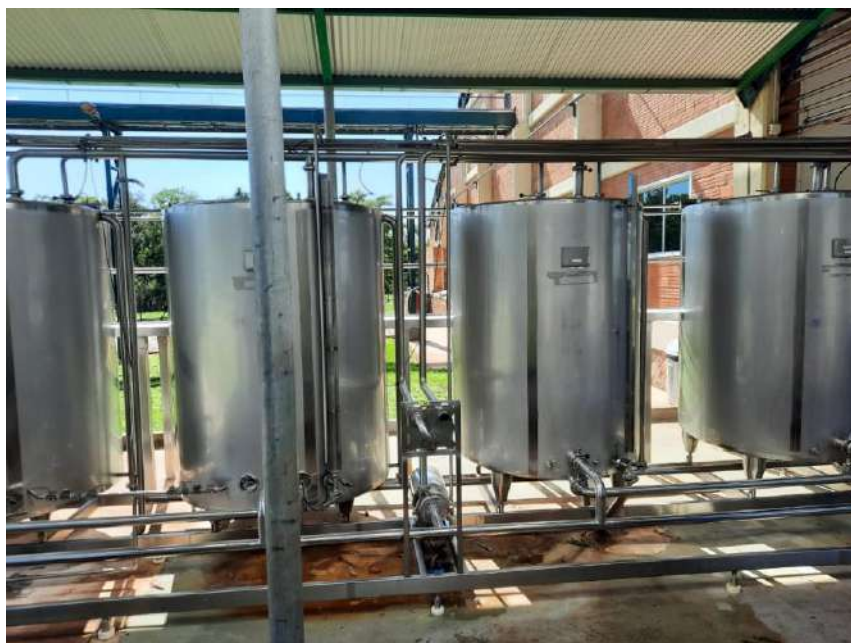
Figura B.4 Tanques del sistema CIP Frontal
