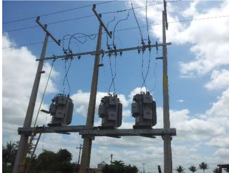
Figura 8.13.3: Vista general del compensador dinámico de 300 kVAr/fase
