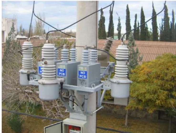
Figura 8.13.5: Vista general de un banco de capacitores de 300 kVAr
