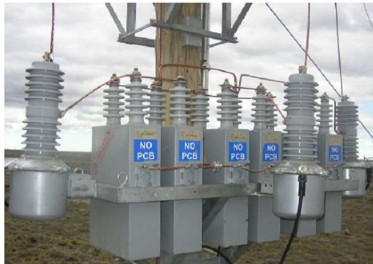
Figura 8.13.4: Vista general de un banco de capacitores de 600 kVAr
