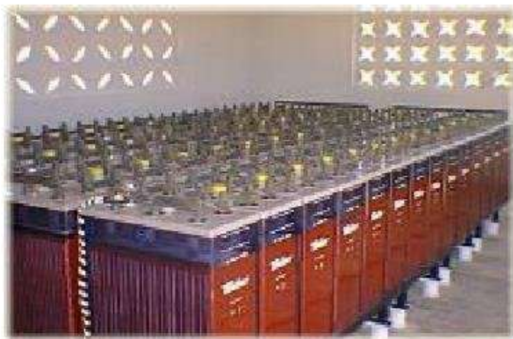
Figura 2.5: Bancos de baterías
