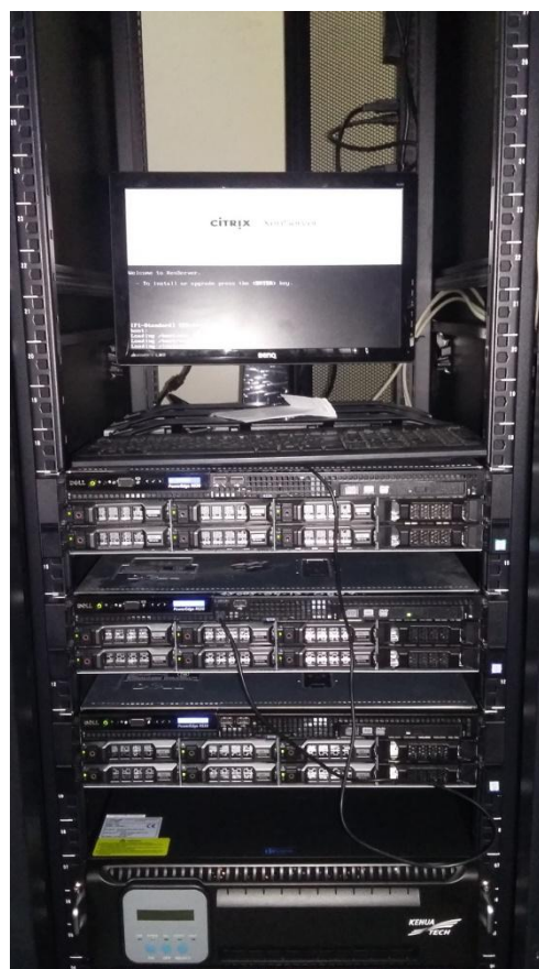
Ilustración 79: Nuevo Rack de la DMH instalado. Fuente: Elaboración propia.
