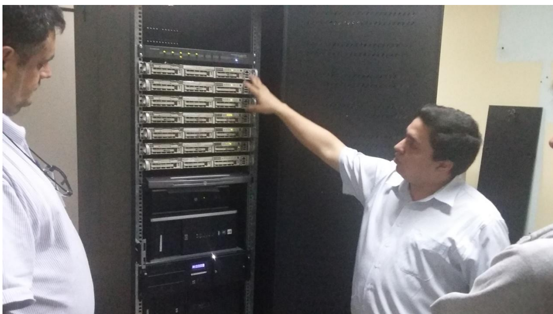
Ilustración 74: Visita técnica a la DMH - Datacenter. Fuente: Elaboración propia.
