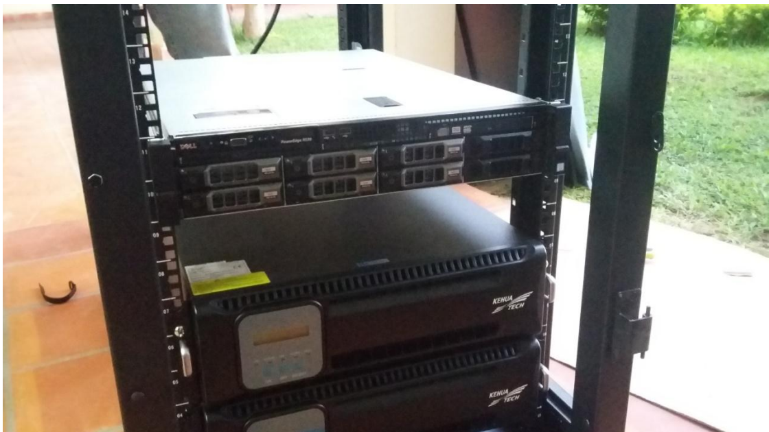
Ilustración 76: Servidor de prueba en nuevo Rack. Fuente: Elaboración propia.
