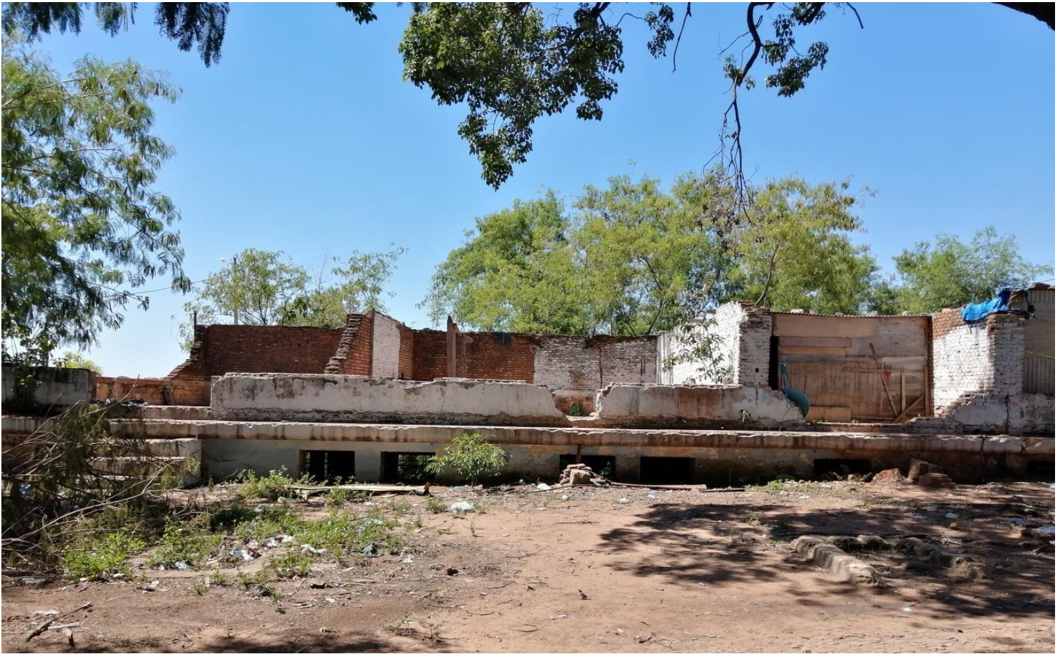
Anexo 10. Fotografías de la zona de estudio: Instalaciones de CAPASA en estado de desmantelamiento
