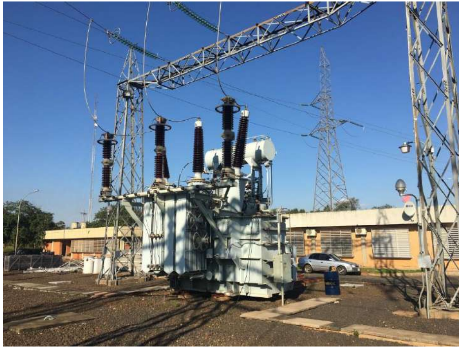
Figura 3: Transformador de Potencia de 41,67 MVA 220/23kV.
