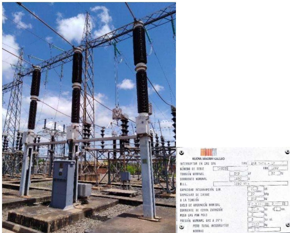
Figura 21: Ubicación del interruptor 71 dentro de la ES-COV y su placa característica.
