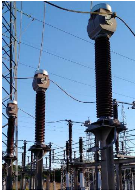
Figura 3: Transformador de corriente.
