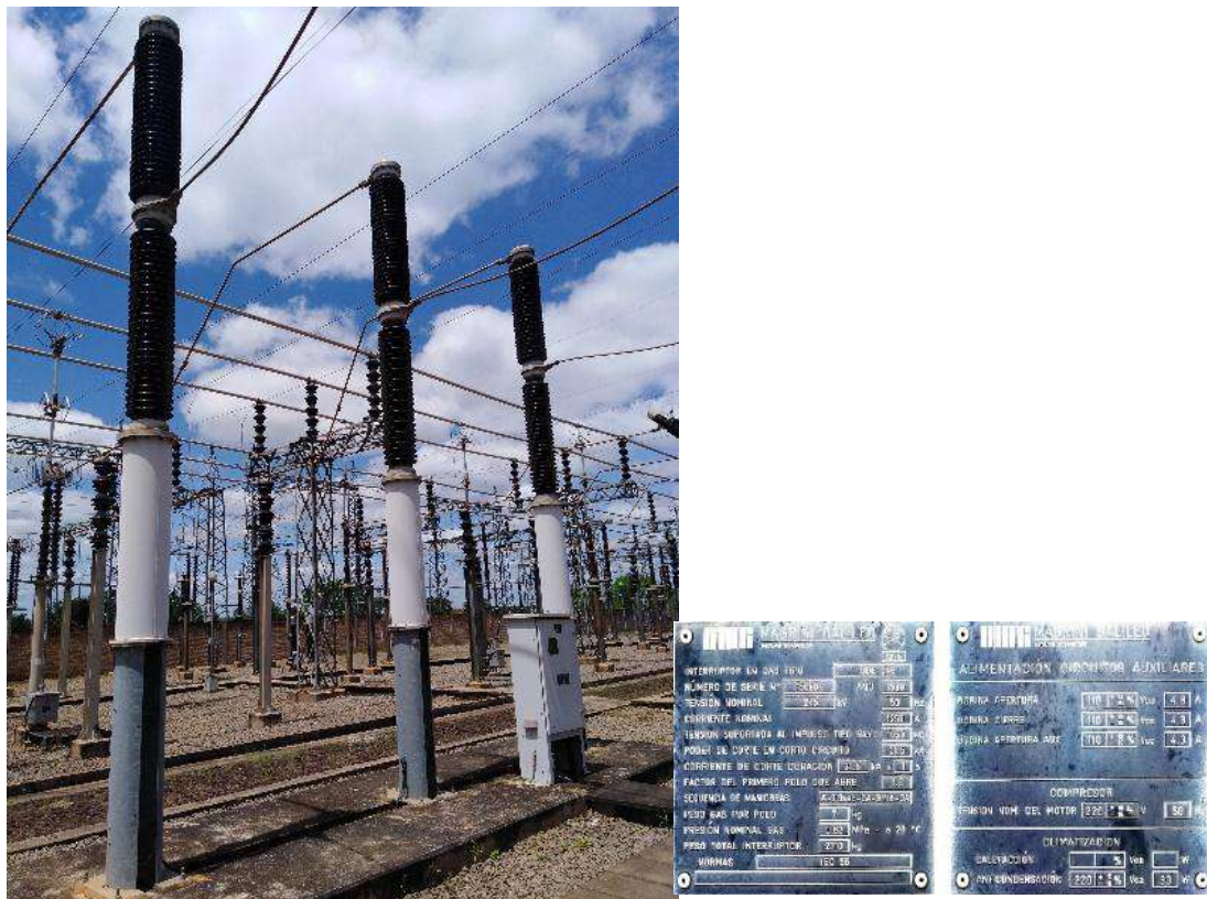
Figura 17: Ubicación del interruptor 83 dentro de la ES-COV y su placa característica.
