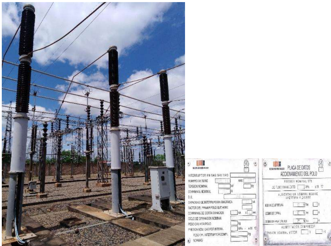
Figura 20: Ubicación del interruptor 74 dentro de la ES-COV y su placa característica.
