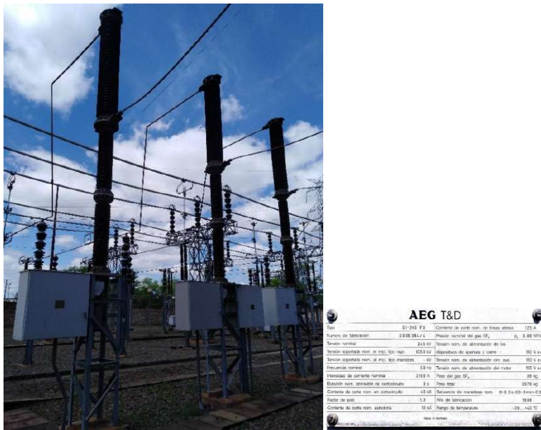
Figura 26: Ubicación del interruptor 73 dentro de la ES-COV y su placa característica.
