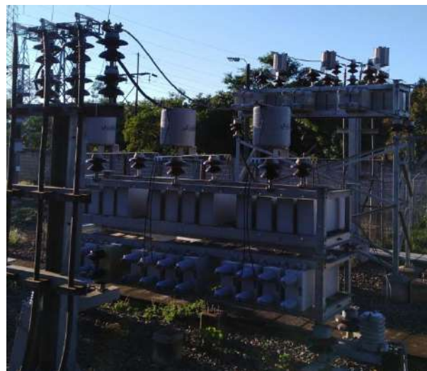
Figura 9: Banco de capacitores de 6 MVAR conectado a la barra de 23 kV.
