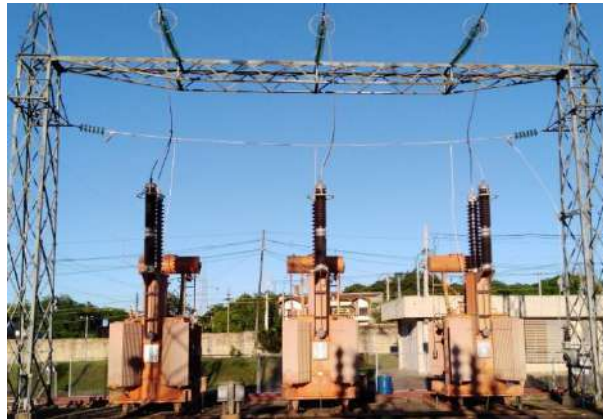
Figura 8: Banco de Reactores de 20 MVAR conectado a la barra de 220 kV.
