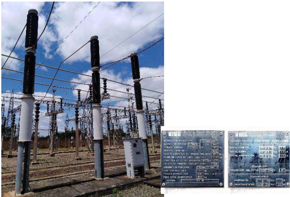
Figura 16: Ubicación del interruptor 84 dentro de la ES-COV y su placa característica.
