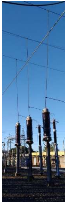
Figura 4: Transformador de Potencial.
