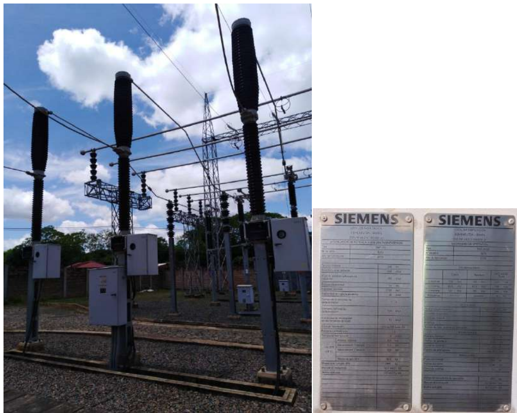
Figura 15: Ubicación del interruptor 95 dentro de la ES-COV y su placa característica.
