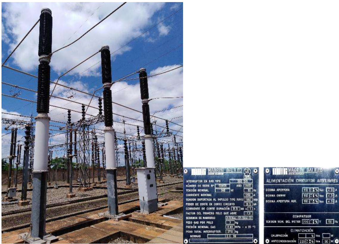
Figura 19: Ubicación del interruptor 78 dentro de la ES-COV y su placa característica.
