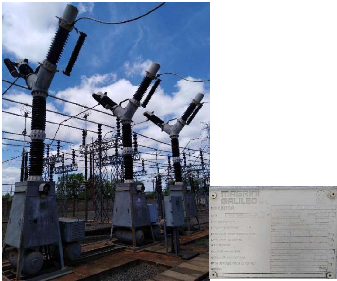
Figura 25: Ubicación del interruptor 77 dentro de la ES-COV y su placa característica.
