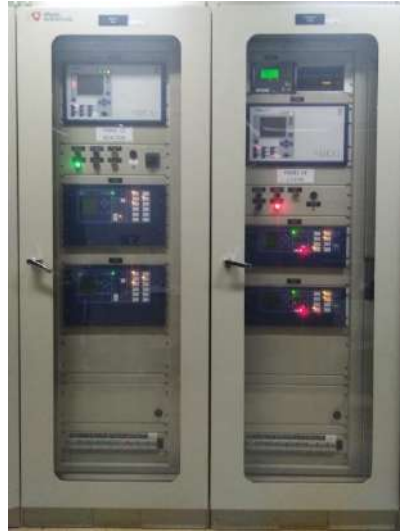
Figura 11: Tableros de la posición 220 kV con sus respectivos equipos de protección, control y medición.
