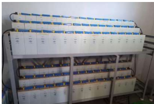
Figura 10: Banco de baterías de 110 Vcc.
