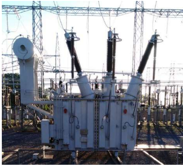
Figura 1: Transformador de Potencia Trifásico de 41,6 MVA.
