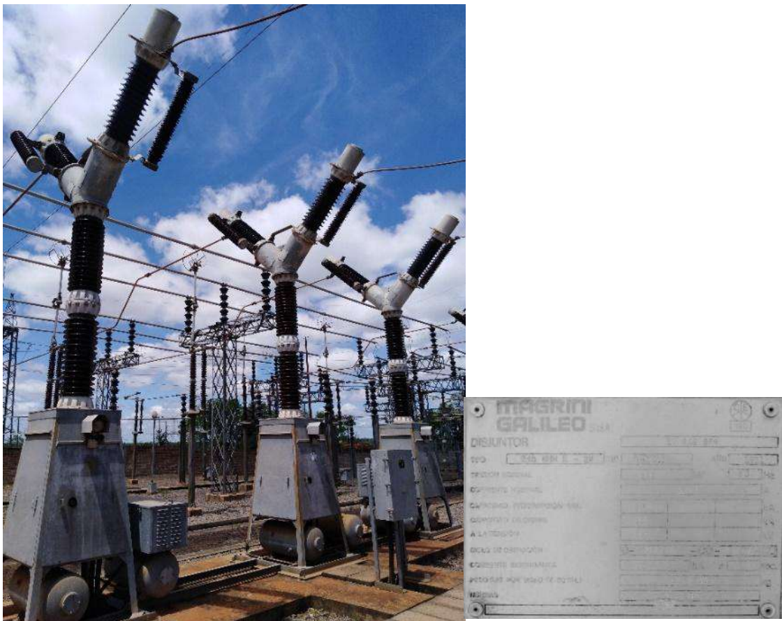
Figura 24: Ubicación del interruptor 76 dentro de la ES-COV y su placa característica.
