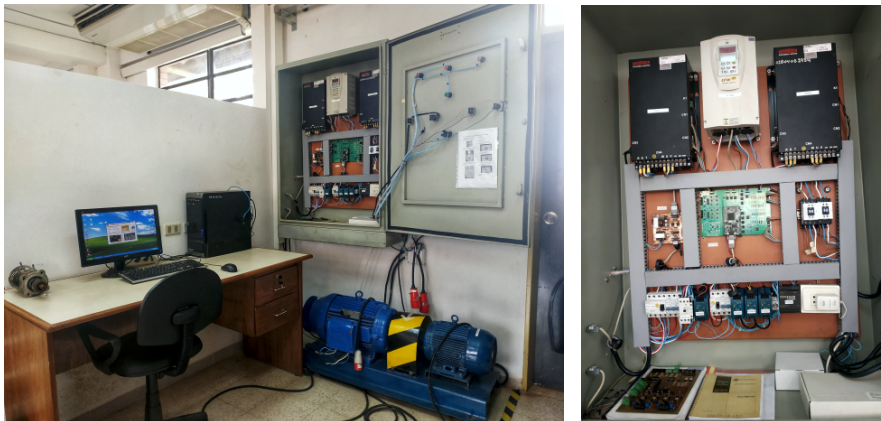
Figura A.1 Fotografía de la bancada de ensayos experimentales del Laboratorio de Sistemas de Potencia y Control (LSPyC)
